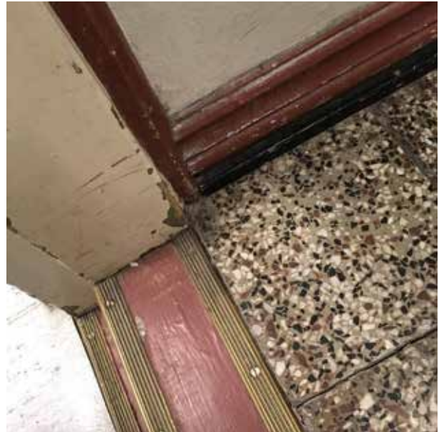
2. kerroksen wc-tilan mosaiikkibetonilaattalattia, profiloitu puinen jalkalista sekä puurakenteinen kynnyks messinkilistoineen. Rakennusosat todennäköisesti 1930-luvulta.
